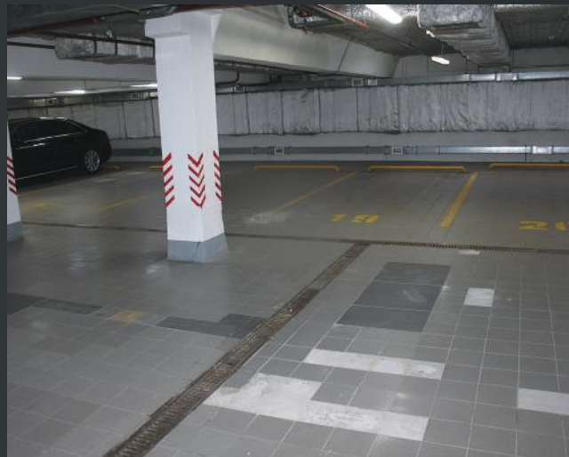
Обследование конструкций пола подземного паркинга ТЦ «Гименей»
